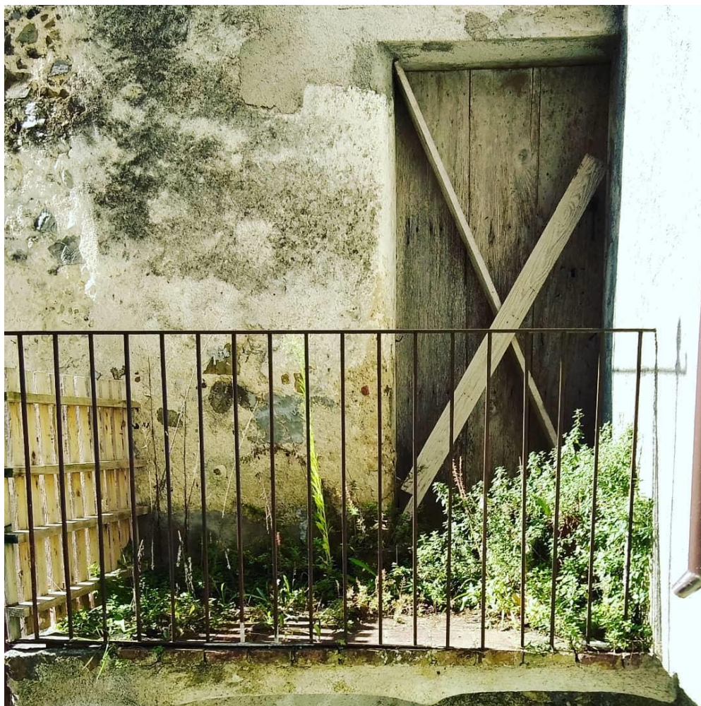
Figura 3. Scorcio di abbandono in un centro storico minore
