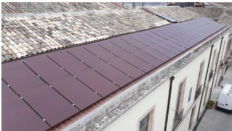
Figura 1. Pannelli fotovoltaici installati sulla copertura del Municipio di Ferla
