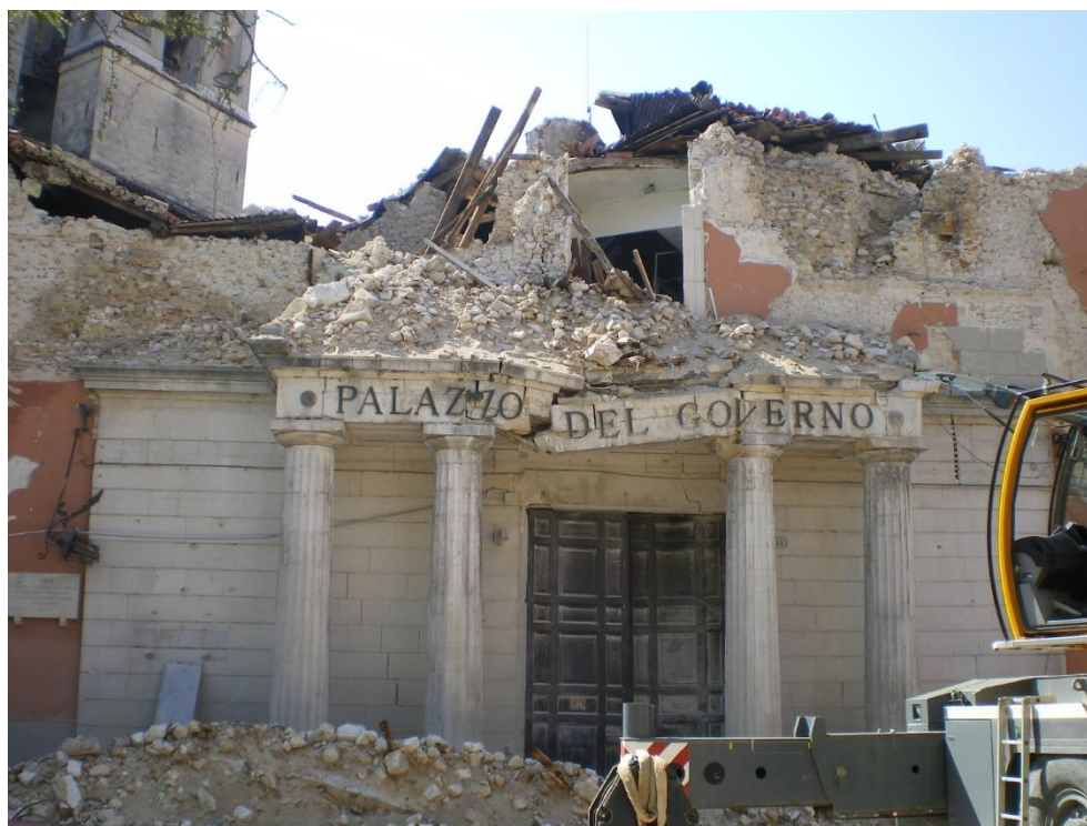
Fig. 1 – La Prefettura dell'Aquila dopo il terremoto del 2009
